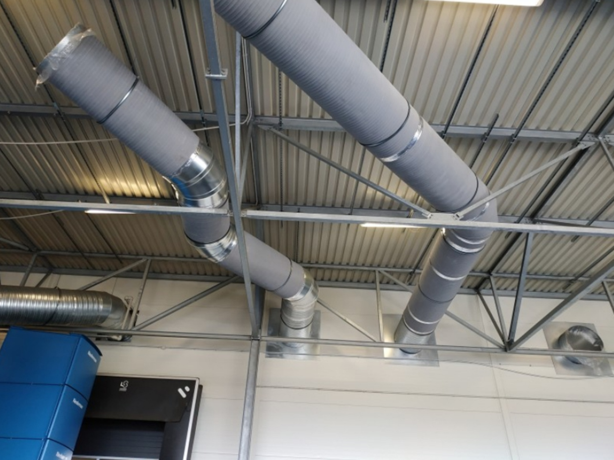
Zaizolované vzduchotechnické potrubí, Zdroj: fotoarchiv Aditex, spol. s.r.o.
