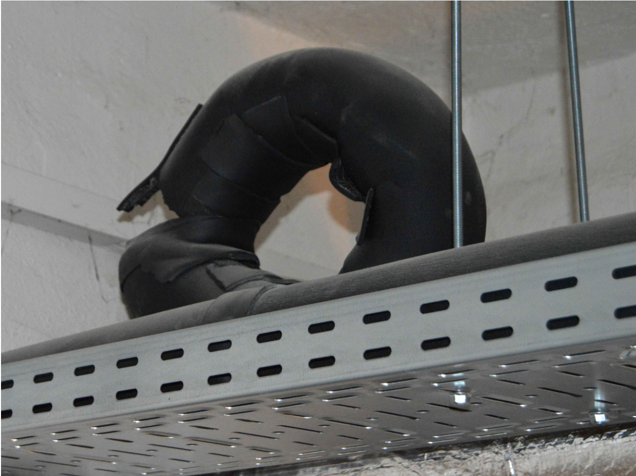
Problématické zateplení složitějších tras rozvodů, Zdroj: fotoarchiv autora
